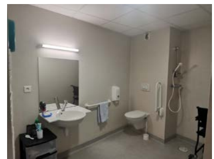
Bloc sanitaire (à côté de chaque chambre)
